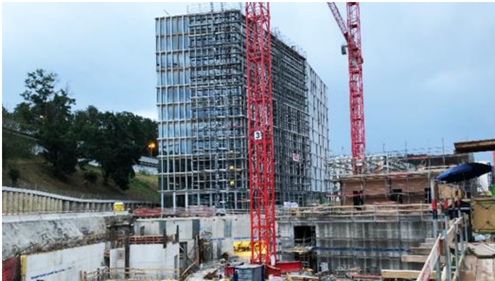
Abbildung 18: Der Einbau eines Kälteverbundsystems (hier Green-City in der Manegg, in Zürich) vermindert die Abgabe von Gebäudeabwärme an die Umgebung (Foto: EBP, 2019)
