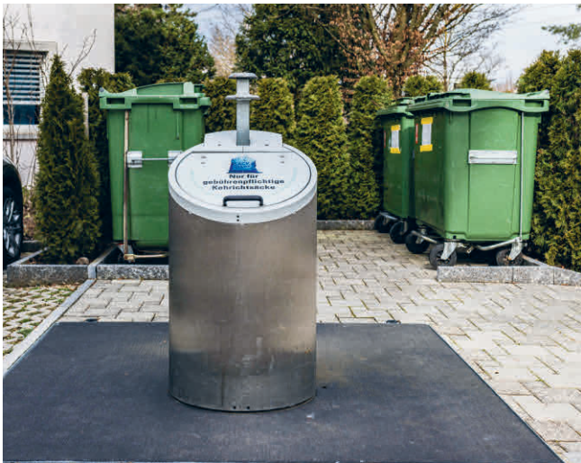
UFC-Anlage in Kombination mit Containern für Grünabfälle
